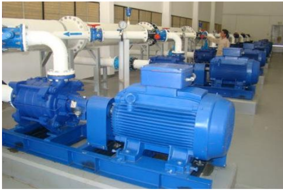
شكل (١) مجموعة من المضخات المركزية بمحطة مياه
