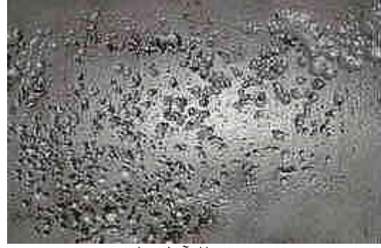
(صورة للتآكل النقرى)
