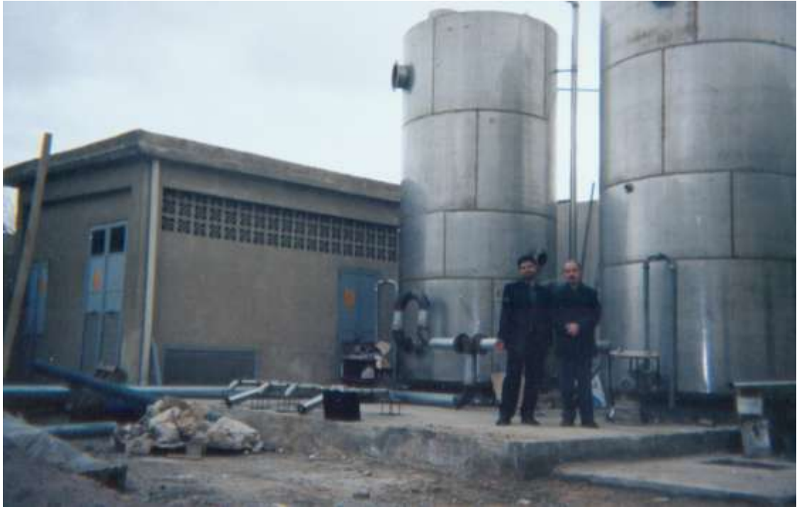
وحدة معالجة مياه صباغ وإعادة الاستعمال
