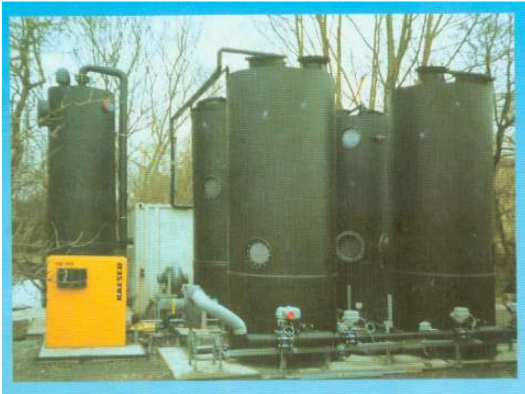
وحدة معالجة مياه صرف لمعمل الحليب – ألمانيا
