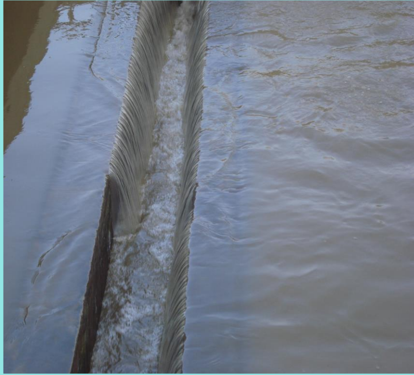
الصورة توضح إيقاف الهواء واستمرار دخول مياه الغسيل لصرف الروبة الى الهدرات
