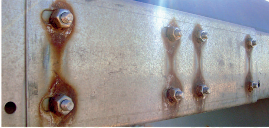
(شكل ١٦-٢-٢): التآكل الكهروكيميائي بين المعادن
