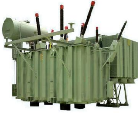
محول الـ 400 - 220 KV الـ 400 - 220 KV
