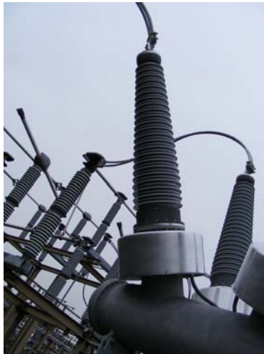
Fig. 19. 230 kV 2000/5 A Bushing CT
