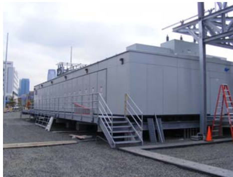
Fig. 23. 26 kV Switchgear (Outside)
